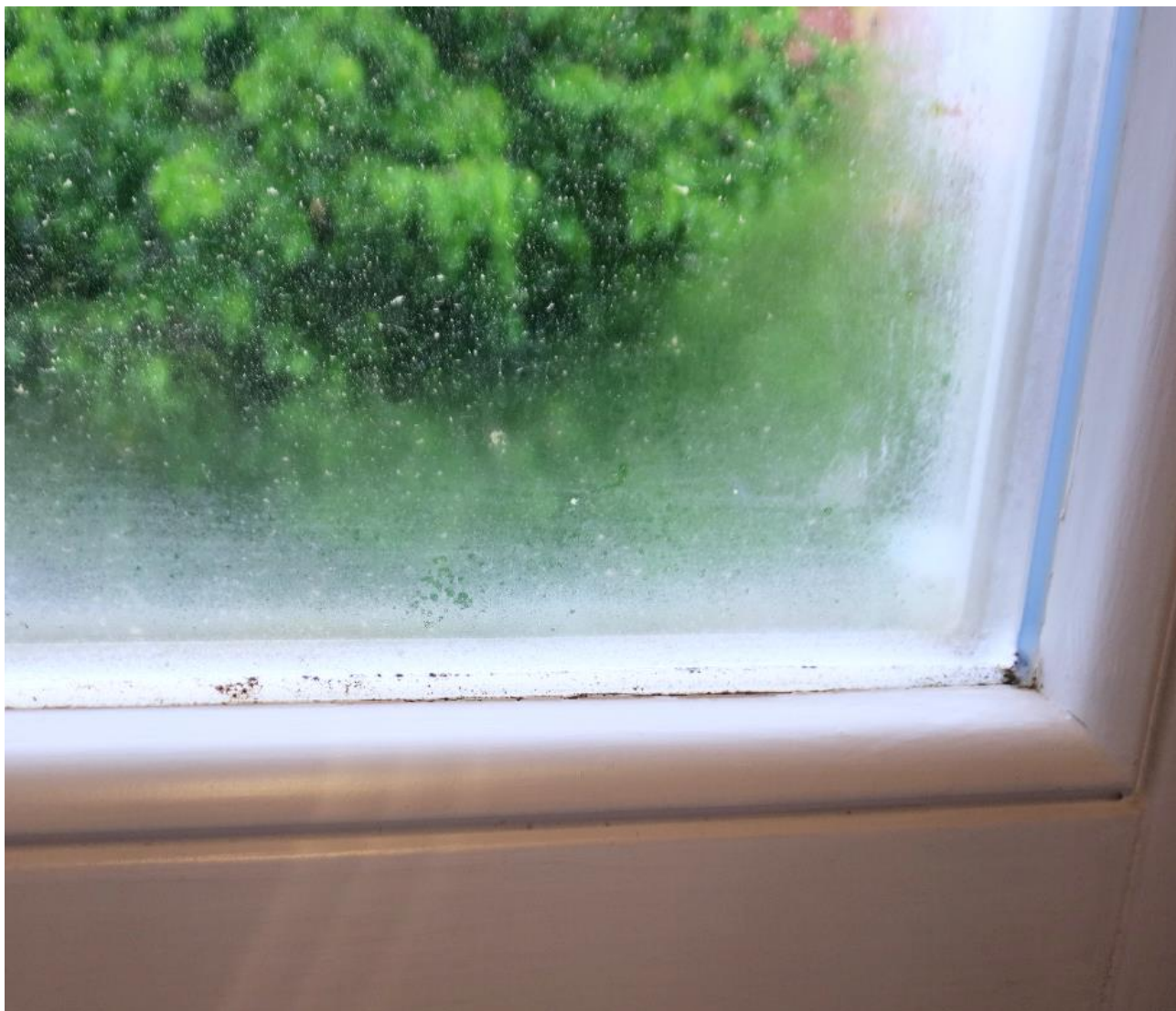
Tauwasserbildung an Fensterscheibe mit Schimmelflecken.
